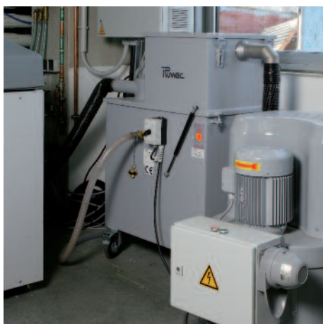
NA 250 Ocelový plech bez filtru zbytkového prachu se sacím agregátem v závodě na zpracování plastů
