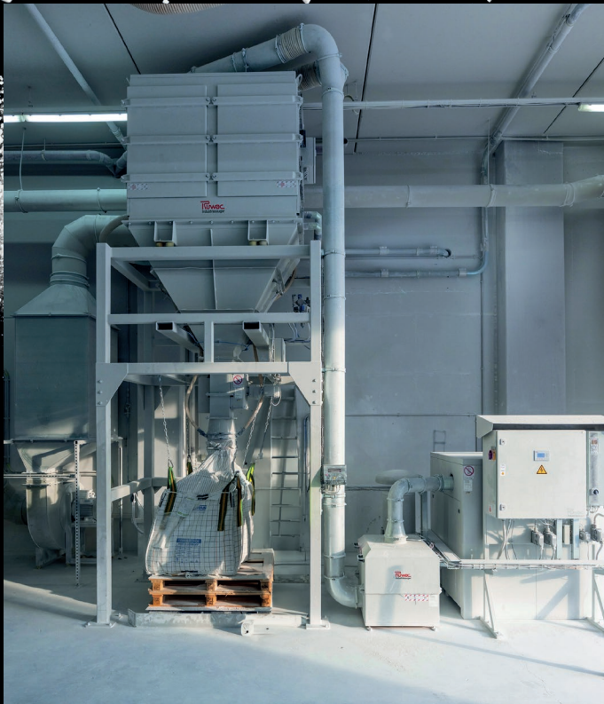
01 Blick auf die Anlage: Das Titandioxid kommt in den Big Bag, und zwar über eine mehrere hundert Meter lange Rohrleitung
